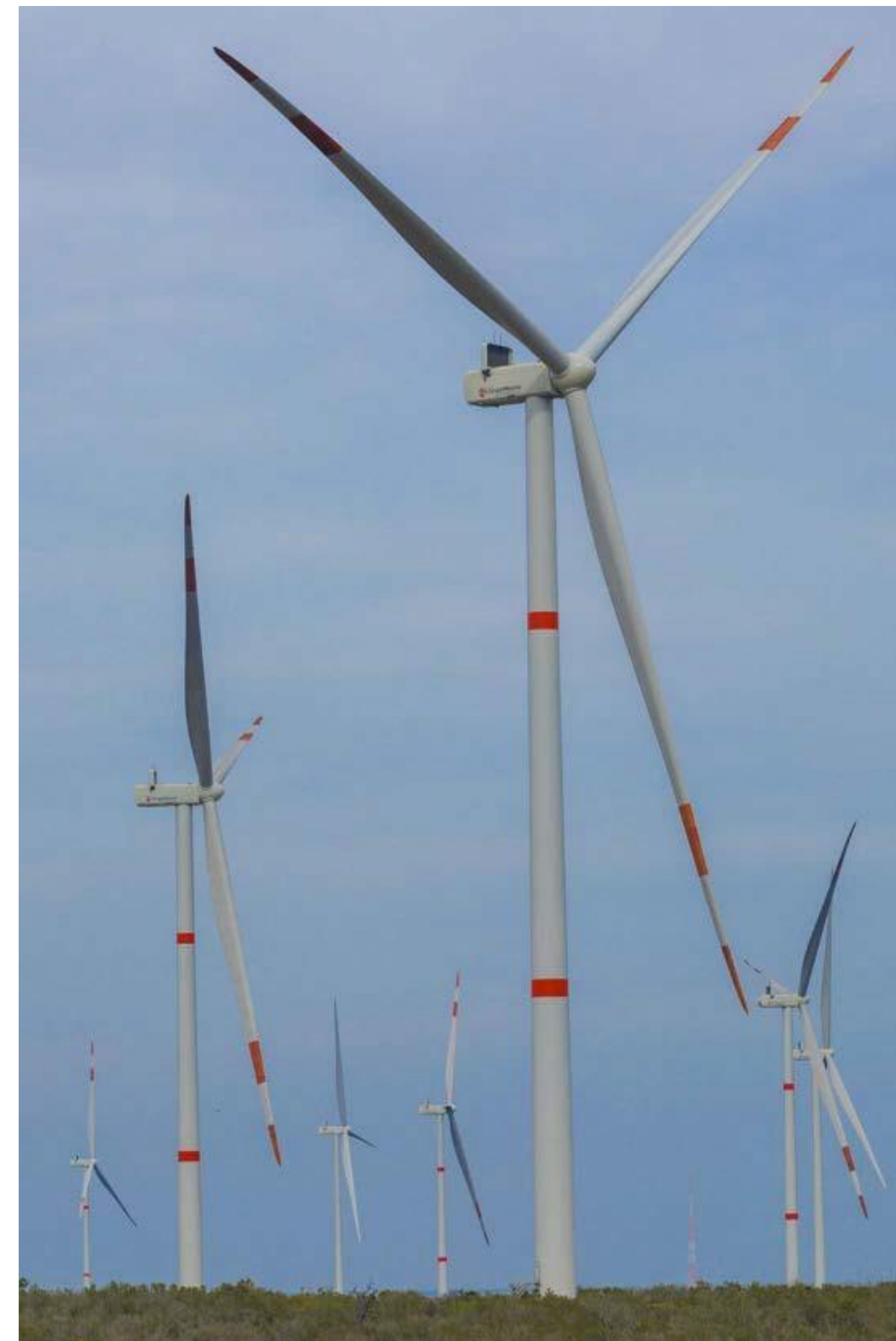
Parque Eólico Fenicias, Nuevo León, México; que abastecerá de energía renovable a las unidades mineras
