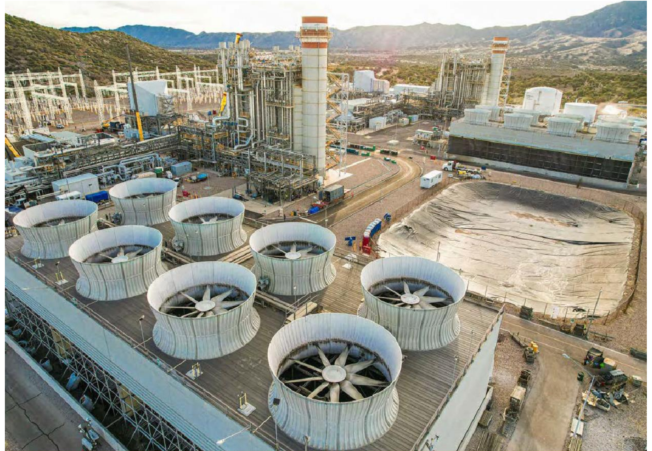
Planta de Ciclo Combinado, Nacoziari de García, Sonora, México; cuya energía abastece las unidades subterráneas de México.
