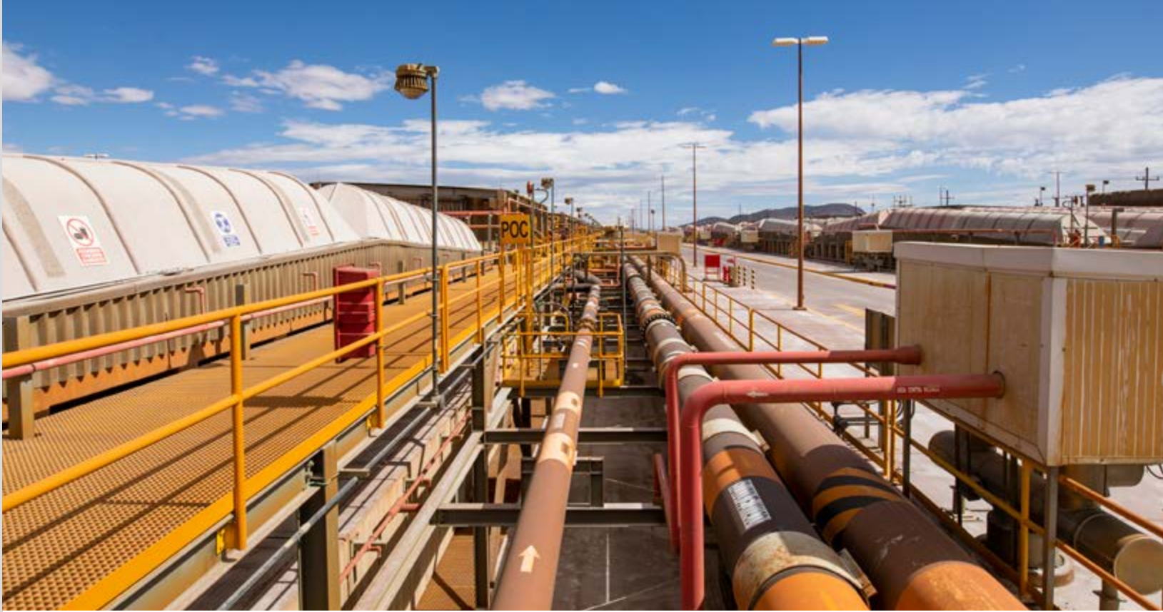
Trenes de extracción por solventes de la planta ESDE de Buenavista del Cobre, Sonora, México.
